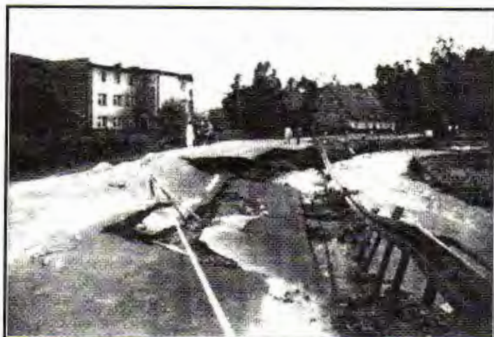
Zniszczona droga do Kostrzycy
