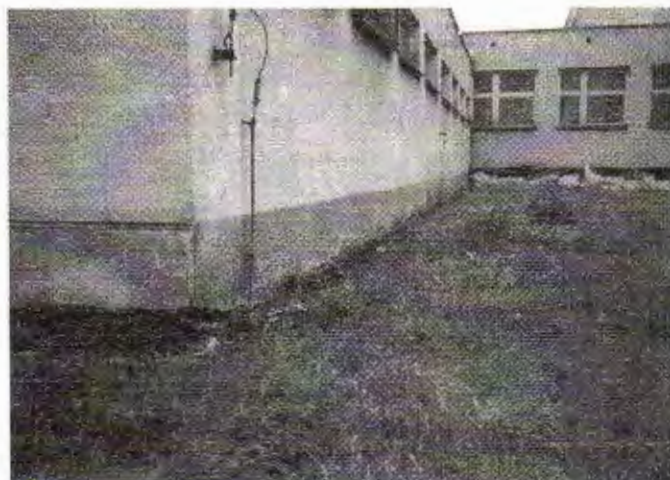
Zalana została Szkoła Podstawowa w Łomnicy. Szczególnie ucierpiała sala gimnastyczna, gdzie zniszczony został parkiet i zaczęły pękać mury.
