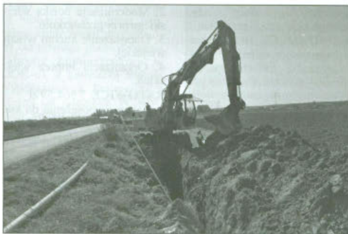
Instalacja wodociągowa znajduje się już kilkaset metrów przed Lipnem
